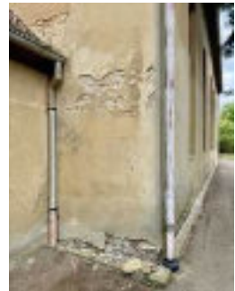
Putzschäden Foto: J. Alex
